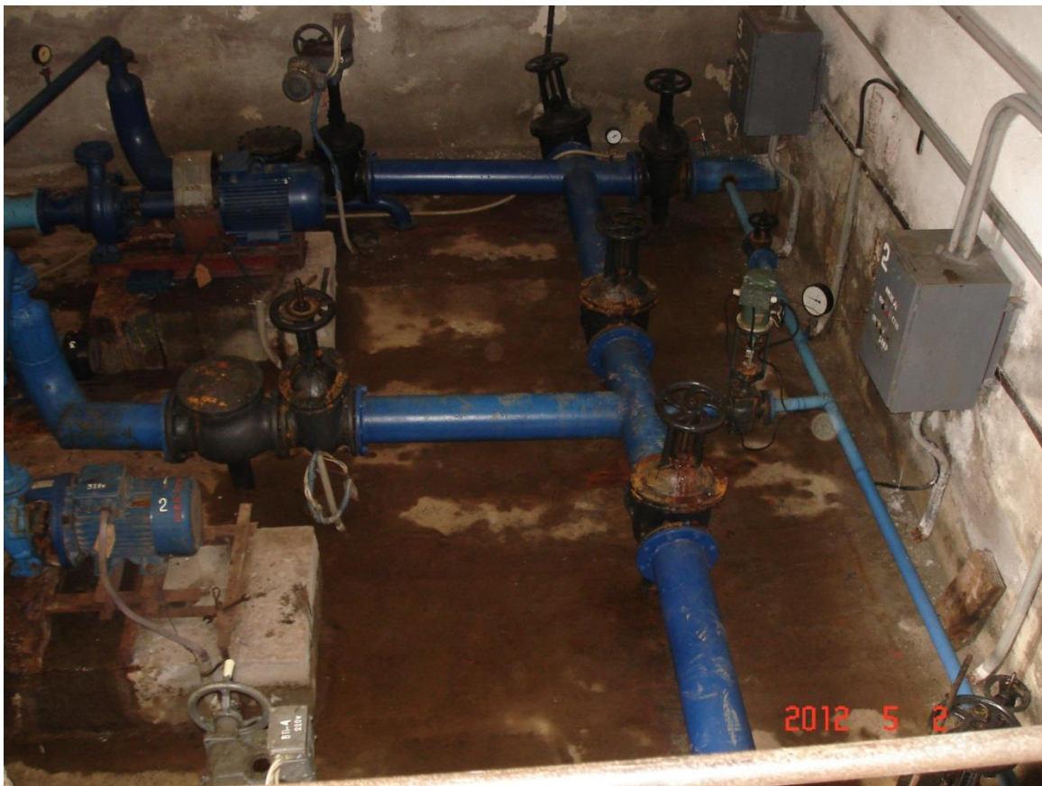
Рисунок 23 Насосная станция 1-го подъема.
