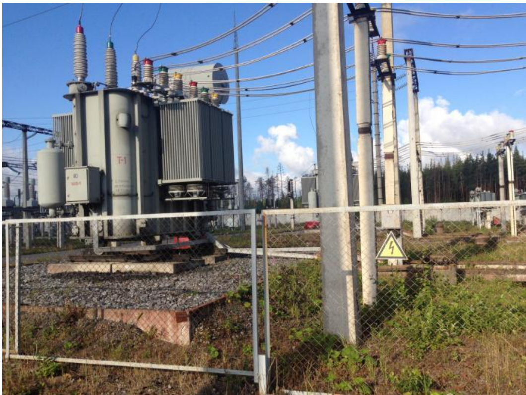
Рисунок 10 Трансформаторная подстанция №549 «Порт»
