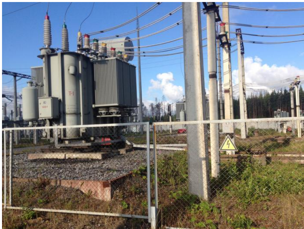
Рисунок 1 Трансформаторная подстанция №549 «Порт»
