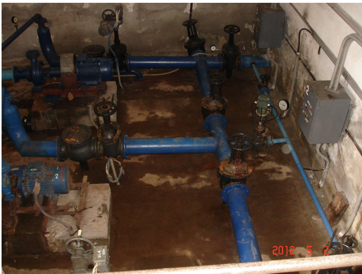
Насосная станция 1-го подъема.
